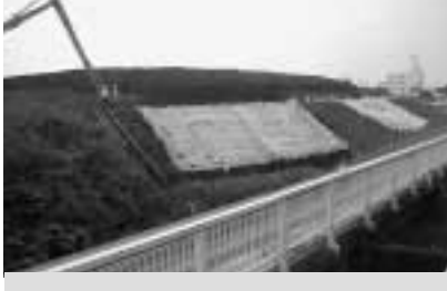
降雨により崩落した盛土。すぐ横はモノレールユーカリが丘線（井野地先）
